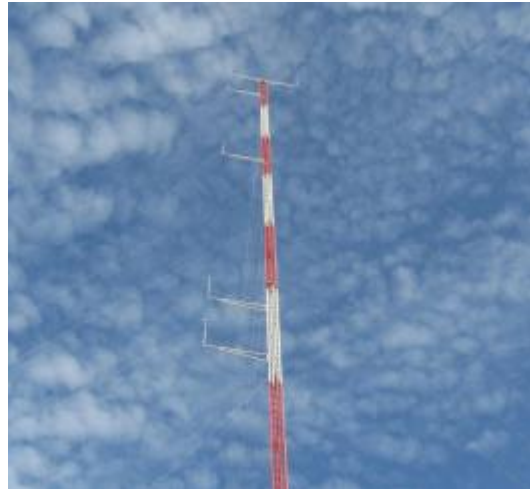
photo 3 : bras de déports et capteurs du mât
